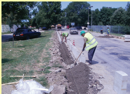
Тротоари на ул. „Васил Левски“ до Каменния мост преди ремонта
